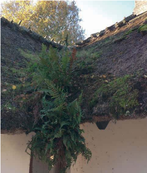
Foto 63 Manglende vedligehold af taget
