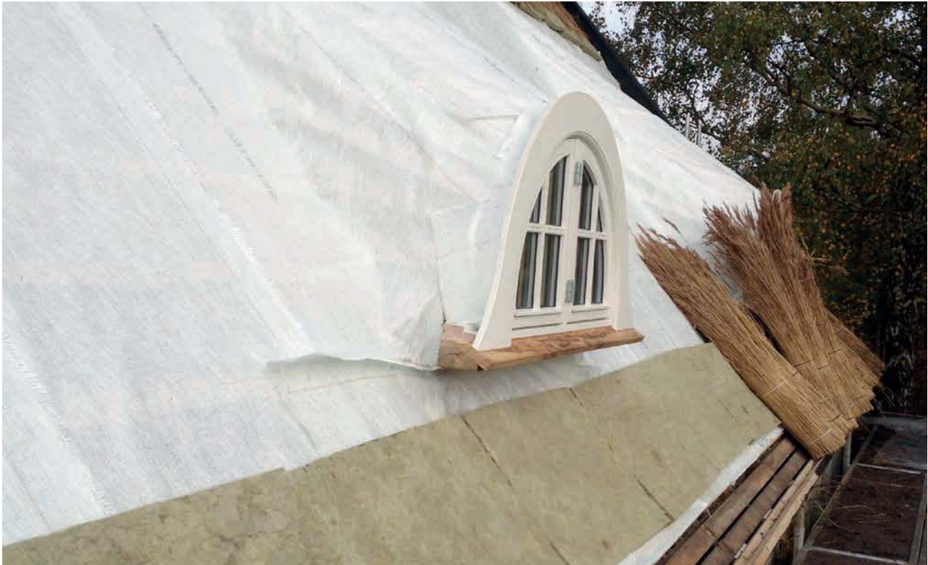
Foto 6 Brandsikring med godkendt glasfiberbug og kantisolering
